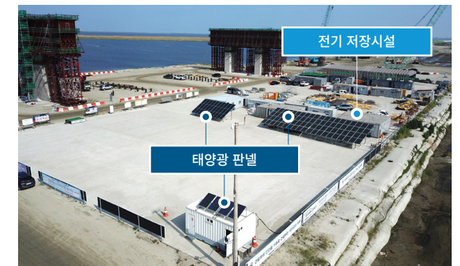
새만금남북도로 3공구 현장 태양광 발전시설 전경
